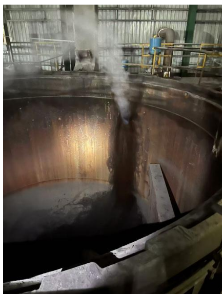
图 7 事故罐排气口反冒蒸汽
