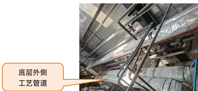
组图 2 事发厂房结构及相关设备布置情况
