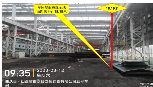
图五事故现场勘察情况
