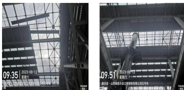
图三事故现场勘察情况
