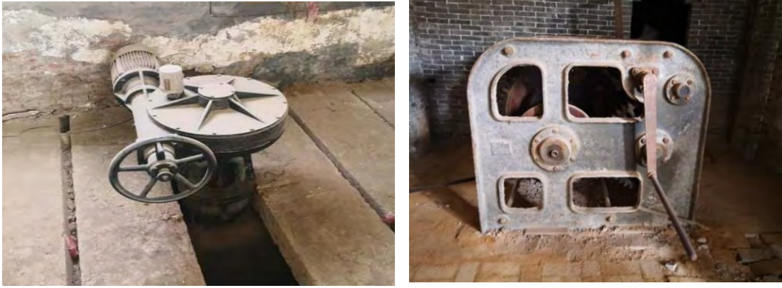
图 3.2-2 灌溉洞设备老化现状
