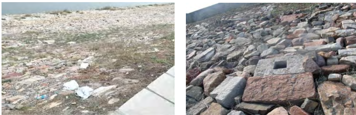
图 3.2-1 上游 0+425~0+910 段干砌石护坡现状
